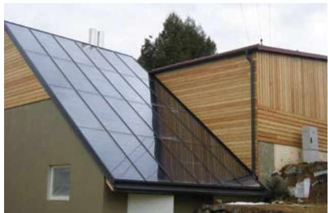
Heizwerk mit Solaranlage Heating station with solar energy
