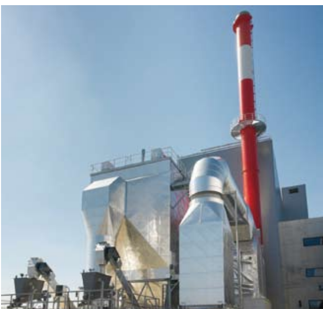
Biomasse-Heizkraftwerk mit integriertem Wärmerückgewinnungssystem Biomass-fired combined heat and power plant (CHP) with integrated heat recovery system
